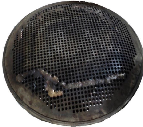
Figura 1.11 Placa perforado Bomba Master MP 2C120 y posición de las grietas y los cordones de soldadura durante su reparación. Fuente: (Noa, Quiza, & Montelie, 2023)
