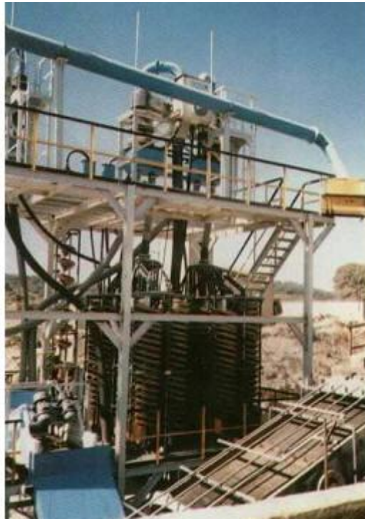
Figura 2.19 Batería de ciclones CBC ( \varnothing 400 mm) en circuito gravimétrico de estaño.
