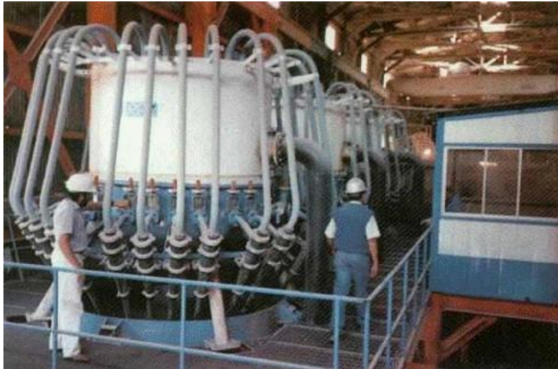
Figura 2.8 Instalación Industrial para el tratamiento de minerales con una batería periférica de ciclones de cono pronunciado.
