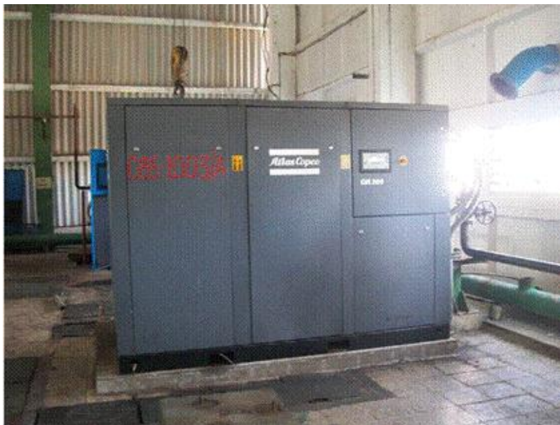
Figura 3.11 Vista General de la Instalación Compresora.
