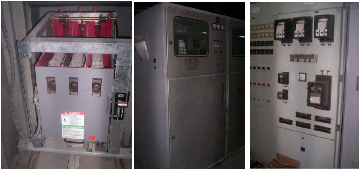
F III.1-1 Fotos de izquierda a derecha, interruptores, panel de protecciones y del transformador, instalados en la actualidad en la subestación principal
