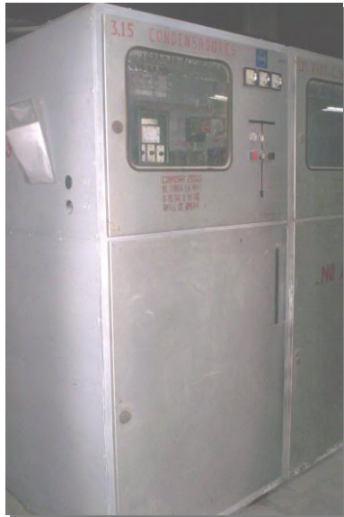
Foto II.3-1 Bloque de protecciones antiguos instalados.
