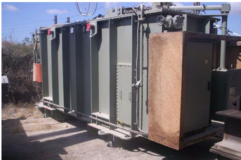
F III.1-2 Vista de transformador similar al que será instalado.
